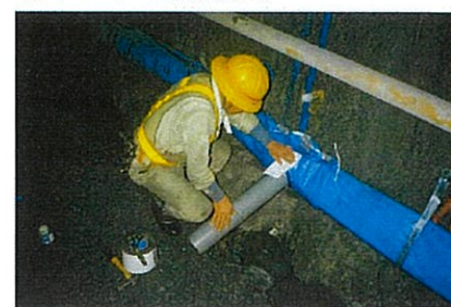
① トンネル裏面排水
