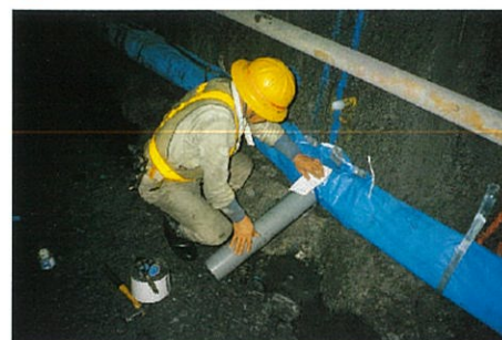
① トンネル裏面排水
