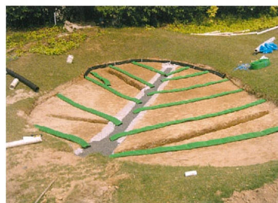
ゴルフ場、グランド排水
